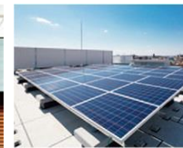
太陽光発電パネル （ヒューリック志村坂上 有料老人ホーム棟）
